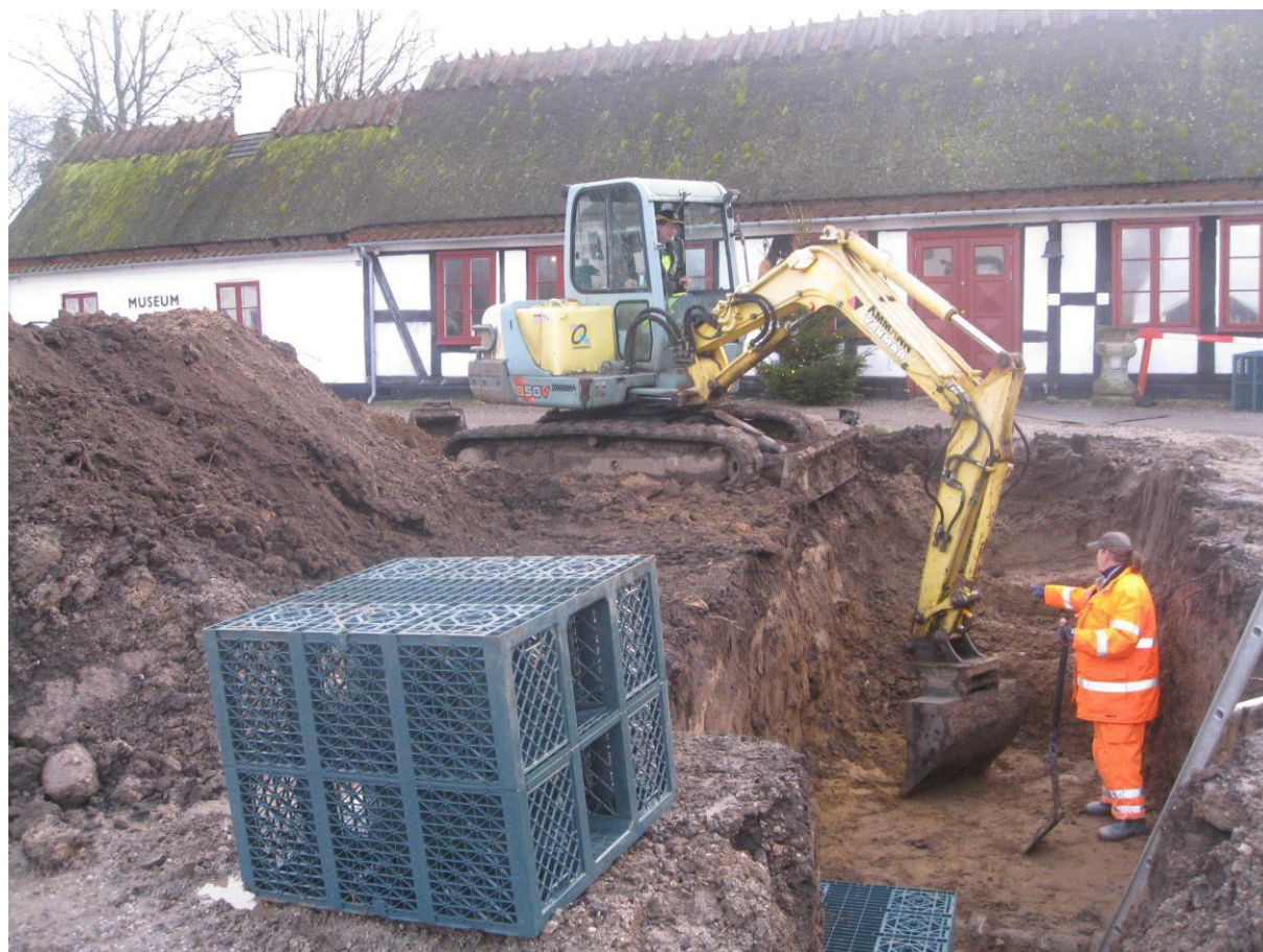
Kloakmester Leon Hansen i færd med at renovere Mothsgårdens kloaksystem. De grønne plastkasser graves ned og fungerer som faskine.
